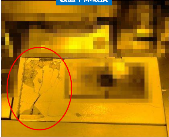
装置下床破損
